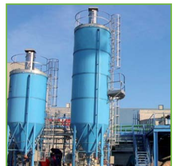
» FILTROS DE PURGA SILOS
