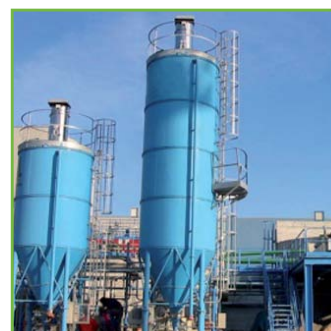
» VENTILACIÓN DE SILOS
